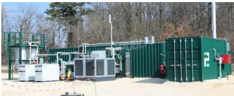
Le biométhane injecté directement dans le réseau correspond à la consommation de 1 800 logements neufs en gaz. Photo LBP /M. C.
