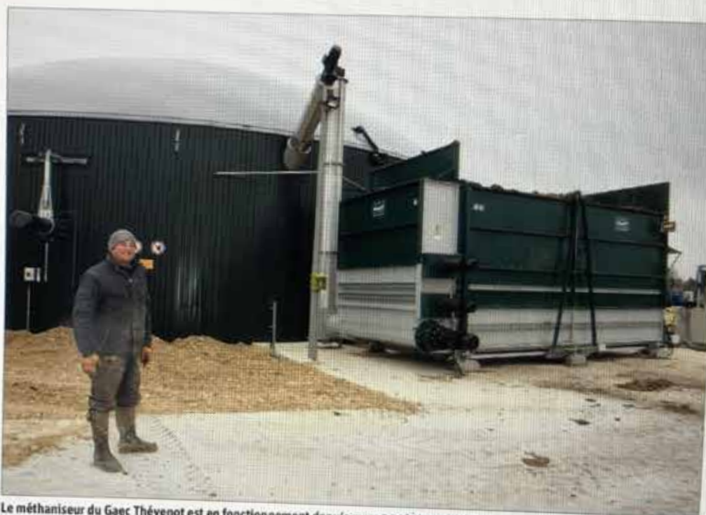
Le méthaniseur du Gaec Thévenot est en fonctionnement depuis mars 2018. Luc Thévenot, cogérant, se trouve ici devant l'enceinte de digestion. Photo d'archives LBP/S. B.
